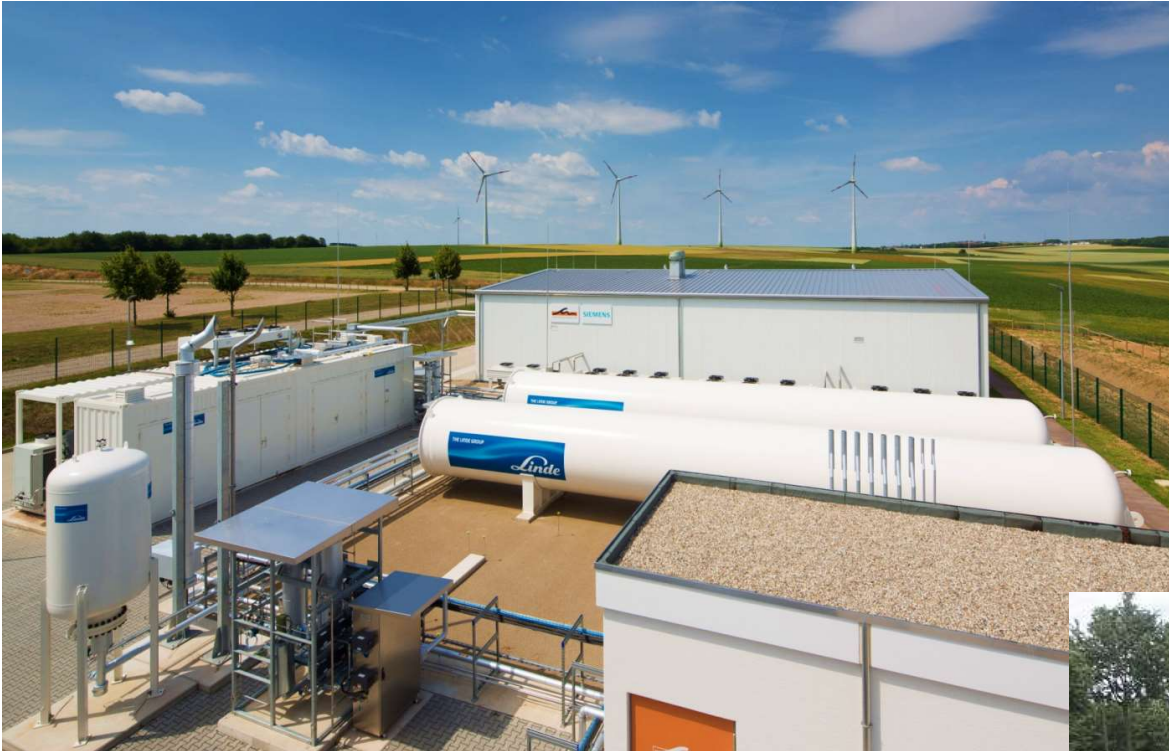
Wasserstoff-Speicher im Energiepark Mainz
